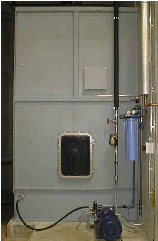
Gehäuse mit Pumpen- und Filterstation
