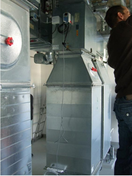
Abb. 9: Einbaufehler eines Volumenstromreglers
